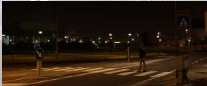
Iluminare trecere pietoni sistem neactivat
