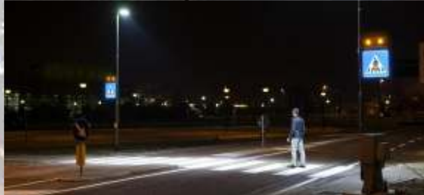
Iluminare trecere pietoni sistem activat
